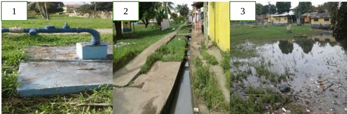
Figura 3 - Área do bombeamento I; em (1) poço tubular; beco Submarino (2) e área alagada onde encontra-se localizado o poço 01 (3).
