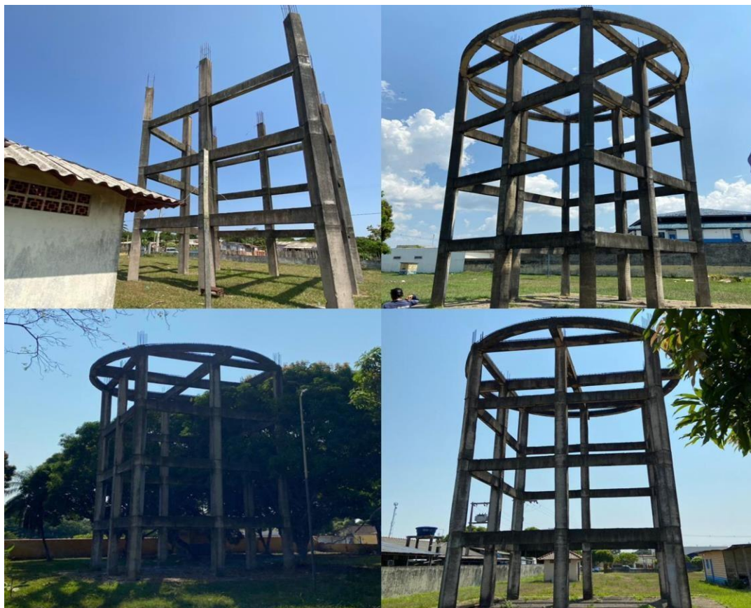
Figura 7. Bases de Concreto Armadas localizadas em alguns terrenos do SAAE.
