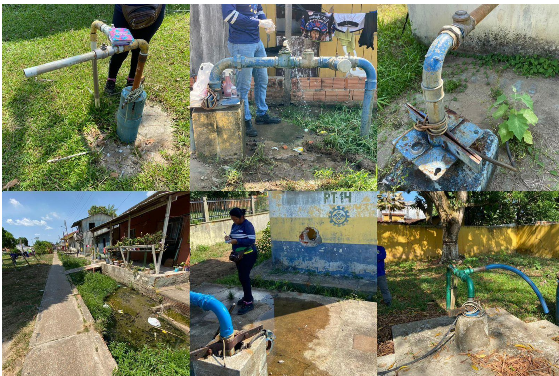
Figura 5. Situação estrutural de alguns PTs localizados na cidade de Parintins.
